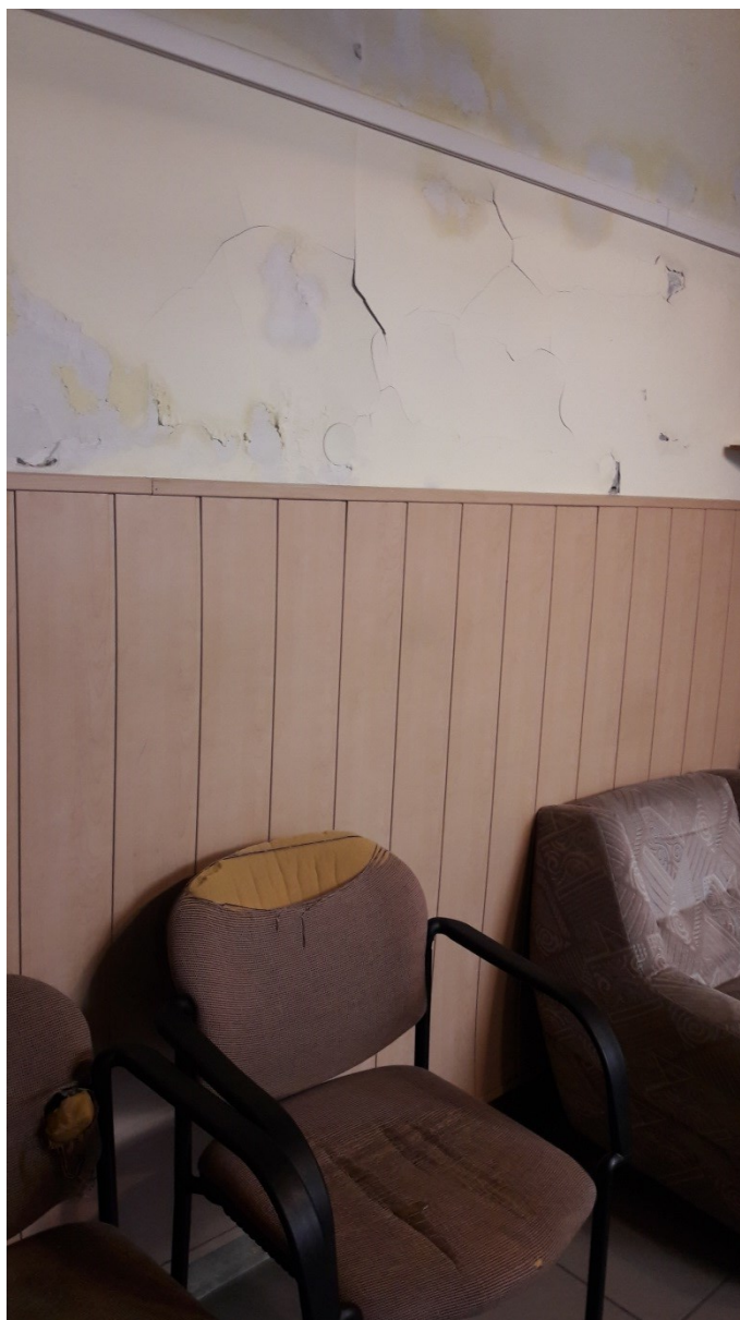
12. kép: omló vakolat és szakadt huzatú szék a személyzeti pihenőben
