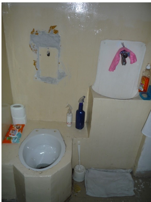
20. kép: Ülőke és tető nélküli körbebetonozott WC-csésze
