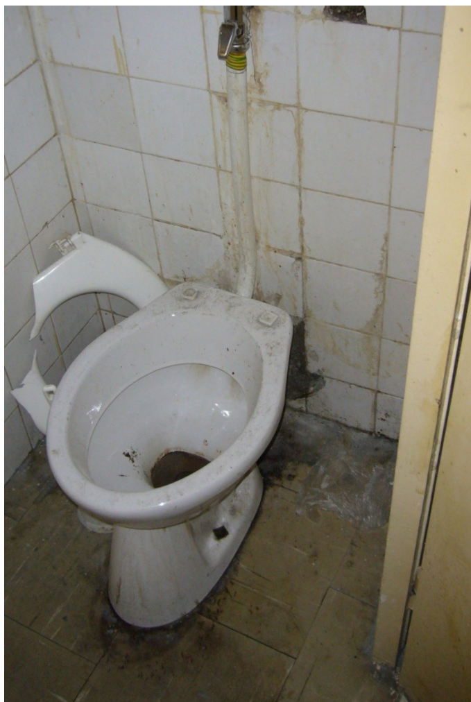
21. kép: hiányzik a tető a WC-kagylóról, mellette a törött WC-deszka
