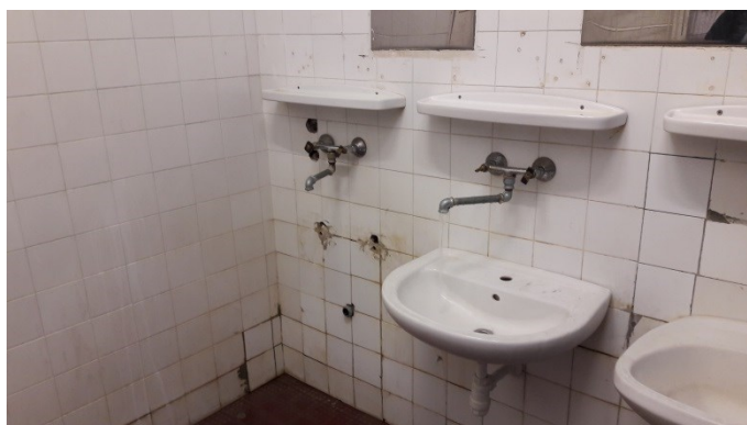
10. kép: hiányzó mosdókagyló
